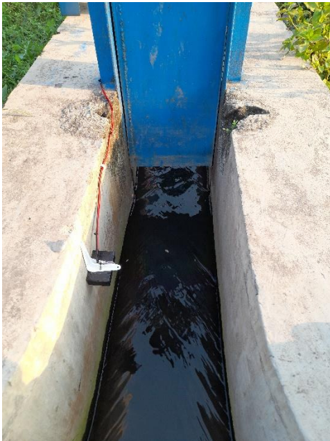
Lampiran 16. Pemasangan Sensor Ketinggian Air
