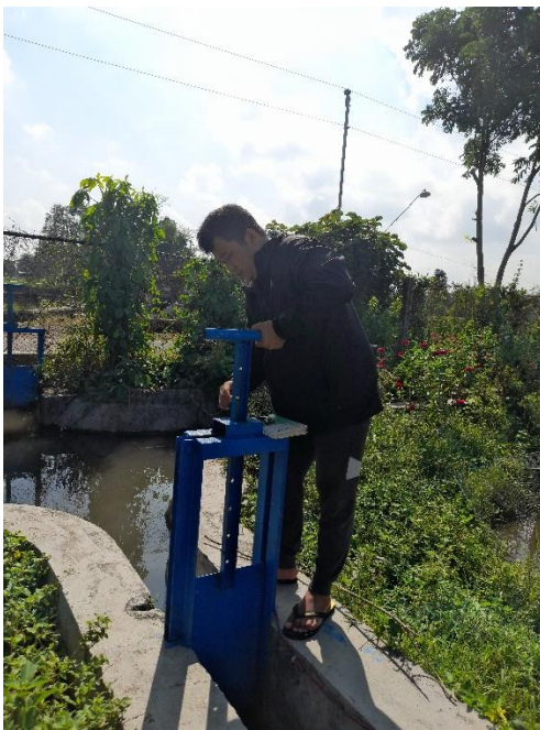
Lampiran 20. Pembukaan Pintu Air Konvensional
