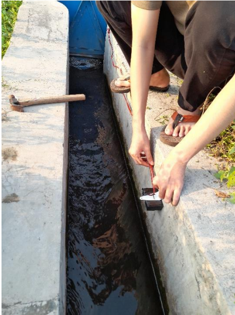
Lampiran 14. Pemasangan Sensor Ketinggian Air
