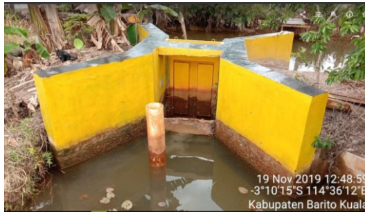
Pintu air outlet satu arah
