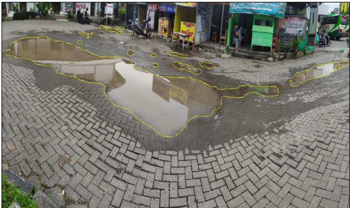
Gambar 5.6. Genangan air di Terminal Banyumanik
