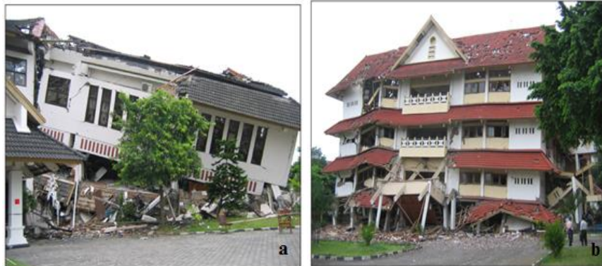
Gambar 1.2 (a) Kerusakan sisi selatan bangunan BPKP Yogyakarta dan (b) bangunan kampus YKPN Yogyakarta akibat gempa bumi di Yogyakarta dengan kekuatan Mw 6,3 pada 27 Mei 2006 pukul 05:53 WIB (Elnashai, dkk., 2007)
